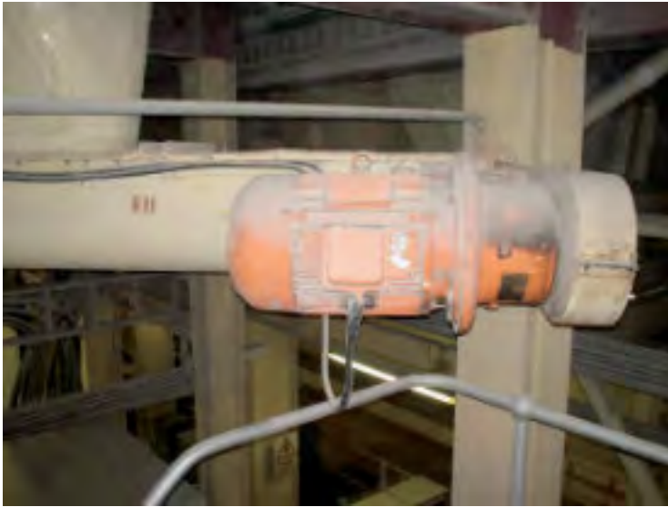
Figura 5.2 - Polvere depositata su un motorino; (HSE,2010)
